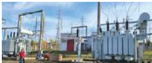
Шинээр суурилагдсан трансформаторын байдал
