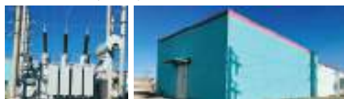
16 МВа-ийн Т-1 трансформаторын зураг
